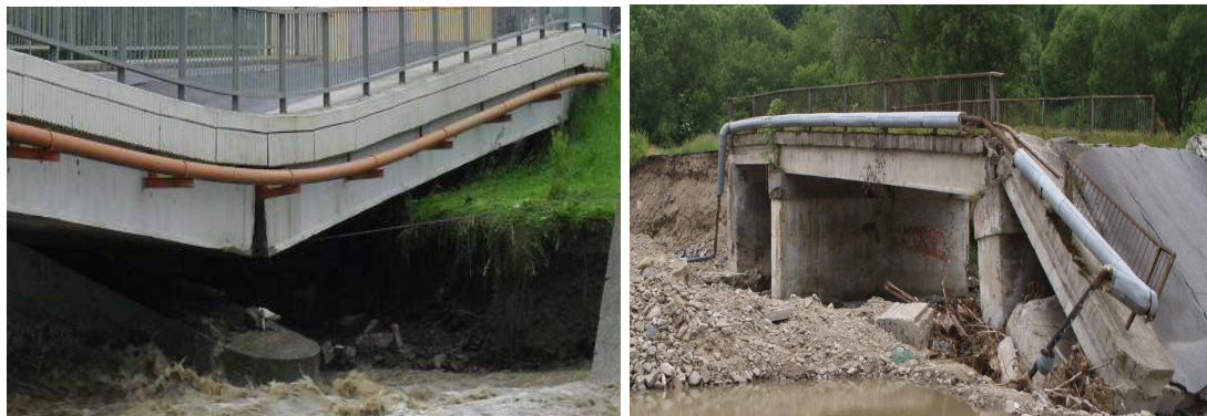
Obr. 3. Poškodenie vodovodných sietí po porušení mostov (foto: Jurík, 2010)
